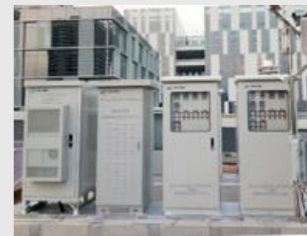
用户侧微电网示范项目（微电网） 深圳湾科技生态园 863 课题微网项目
