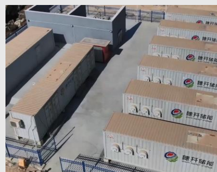
电化学储能成套设备项目（需求侧） 大湾区唯一进入量产12英寸芯片制造商 广州粤芯半导体
